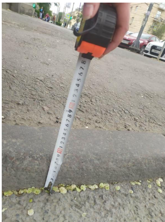
Рис. 3. Ненормативный перепад между бордюрным пандусом и дорожным покрытием
