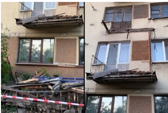
Рис. 2. Обрушение балконных конструкций на Лесном пр., д. 37 [11]
