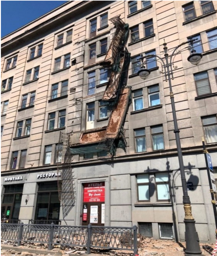
Рис. 1. Обрушение балконных конструкций на Кирочной ул., д. 20
