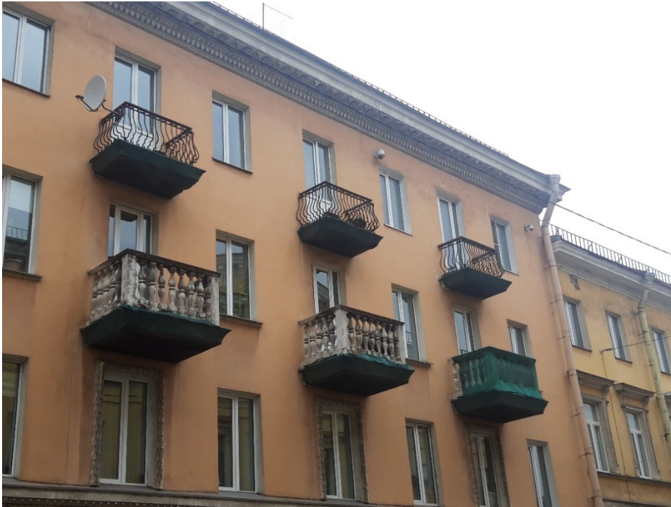
Рис. 14. Большая Подьяческая ул., д. 35. Укрытие аварийных участков балконов полимерной сеткой
