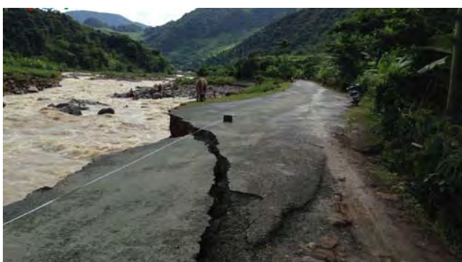
Рис. 3. Размыв участка автомобильной дорог в области Фу Иен (Центральный Вьетнам)
