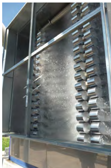
Рис. 2. Промышленная камера орошения со стороны входа воздуха в торговом центре «Три кита», г. Москва
