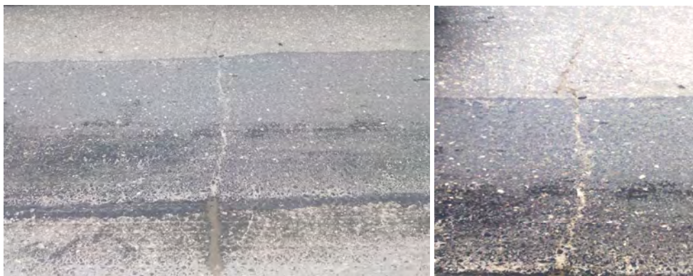
Рис. 1. Копирование старой трещины (фото слева) на дорожном покрытии через год эксплуатации городской дороги (фото справа)
