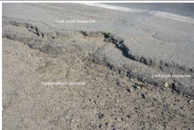
Рис. 4. Превышение кромки проезжей части над обочиной: слева — федеральная дорога Р-228; справа — дорога Волгоград — Астрахань
