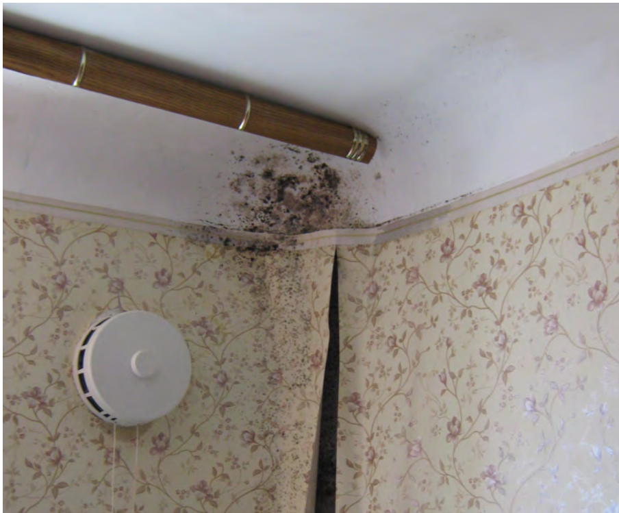
Рис. 2. Образование плесени на внутренней поверхности сопряжения внутренних и наружных стен в жилой комнате
