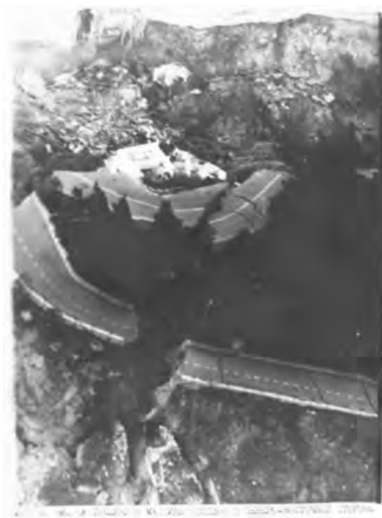
Рис. 4. Вид на стену срыва и трещину в массиве оползня с северо-восточной стороны
