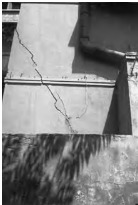
Рис. 5. Угловой откол в торцевой части здания
