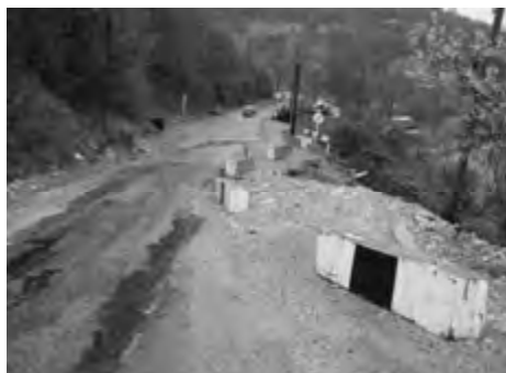
Рис. 1. Оползневое смещение на автомобильной дороге Лазаревское — Кирова, км 2+800
