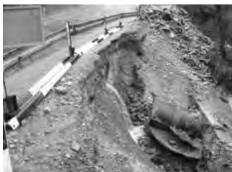
Рис. 4. Деформация водопропускной трубы на автомобильной дороге Лазаревское — Кирова, км 3+600
