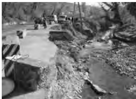
Рис. 2. Разрушенный оползнем участок автомобильной дороги Веселое — Нижняя Шиловка, км 3+690
