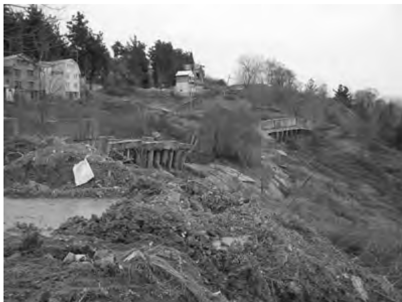
Рис. 1. Разрушение оползнем свайного сооружения в голове оползня
