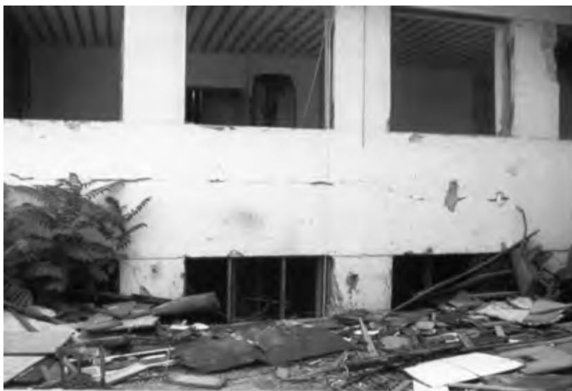
Рис. 2. Горизонтальная трещина в стене со стороны внутреннего фасада
