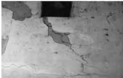
Рис. 4. Косая трещина в нижней части стены со стороны внутреннего фасада
