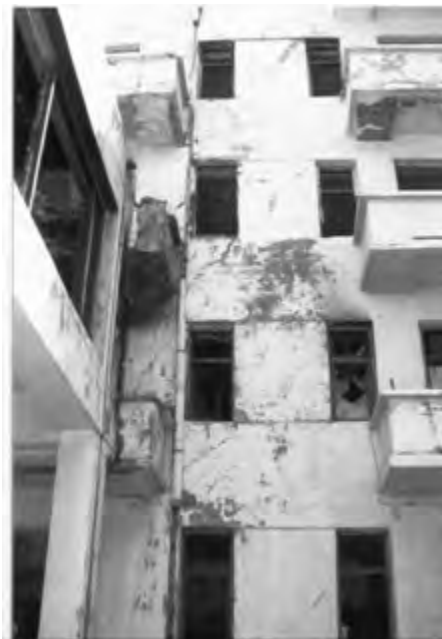
Рис. 3. Косые трещины в несущих элементах со стороны внутреннего фасада
