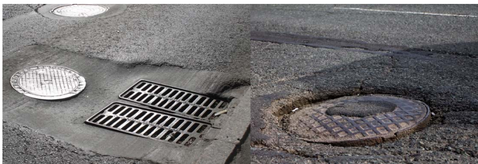
Рис. 5. Просадки проезжей части УДС у смотровых колодцев и дождеприемных решеток
