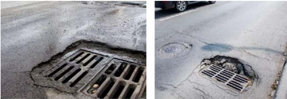
Рис. 2. Дорожное покрытие у ливневых решеток
