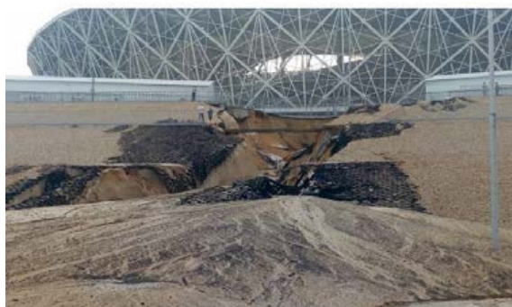
Рис. 13. Размывы склонового откоса у стадиона «Волгоград Арена»
