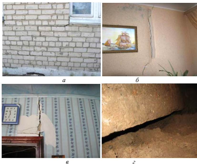
Рис. 5. Визуальные деформационные разрушения здания: а — вертикальные, горизонтальные и наклонные сквозные трещины в наружных кирпичных стенах здания с шириной раскрытия до 18 мм; б, в — деформации и просадки фундаментов здания в результате образования пустот (глубиной до 250 мм) в грунтовом основании под сборными железобетонными плитами ленточного фундамента; г — вертикальные и наклонные сквозные трещины во внутренних кирпичных стенах здания с шириной раскрытия до 16 мм
