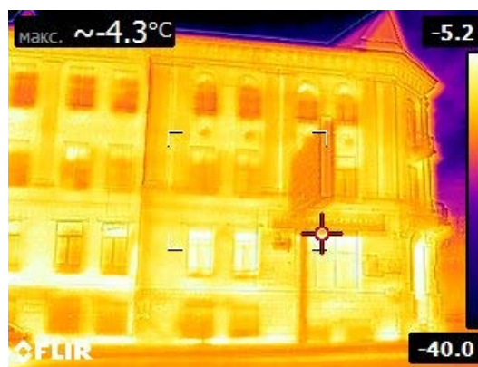
Рис. 2. Термограмма участка покрытия объекта обследования
