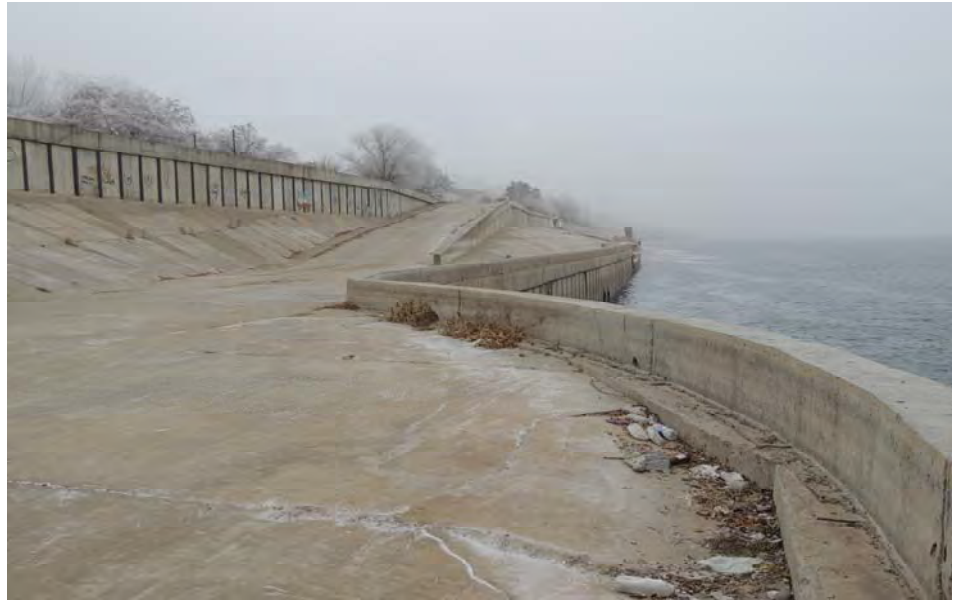
Рис. 6. Состояние берегоукрепительных сооружений набережной Нижнего поселка Волгоградского тракторного завода г. Волгограда
