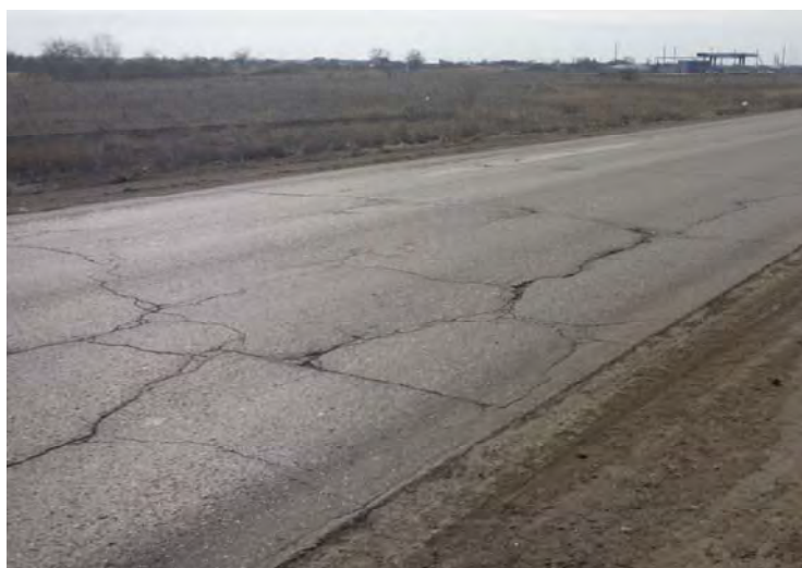
Рис. 1. Сетка трещин на участке автомобильной дороги Волгоград — Краснослободск — Средняя Ахтуба
