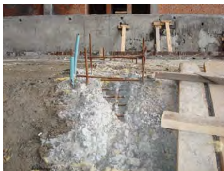
Рис. 2. Дефекты бетонирования дна ванны бассейна
