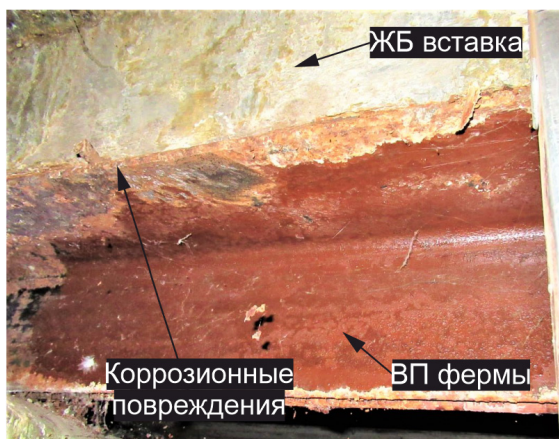
Рис. 5. Коррозионные повреждения поясов в зоне контакта с железобетонными плитами в результате систематического замачивания
