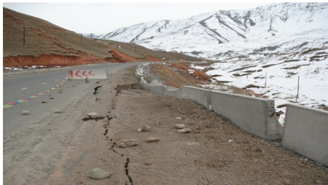
Рис. 1. Участок просадки на участке автомобильной дороги Ош — Сары-таш — Иркештам
