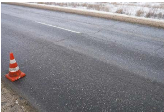
Рис. 2. Продольные и поперечные трещины.
