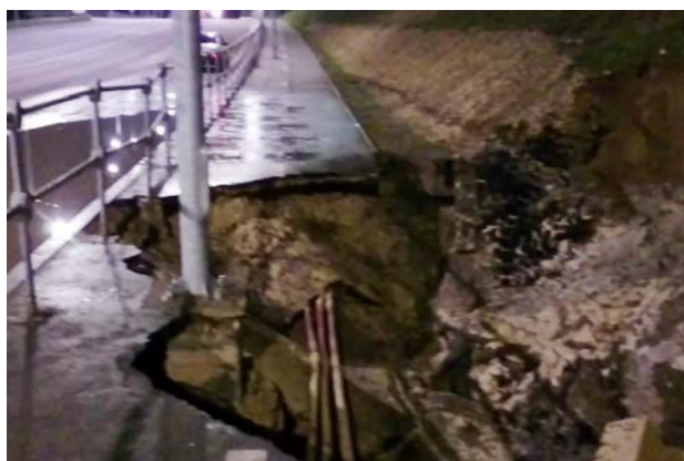
Рис. 5. Обрушения тротуарной зоны после ливневых дождей.
