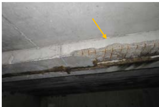
Рис. 1. Хлоридная коррозия монолитной железобетонной балки перекрытия
