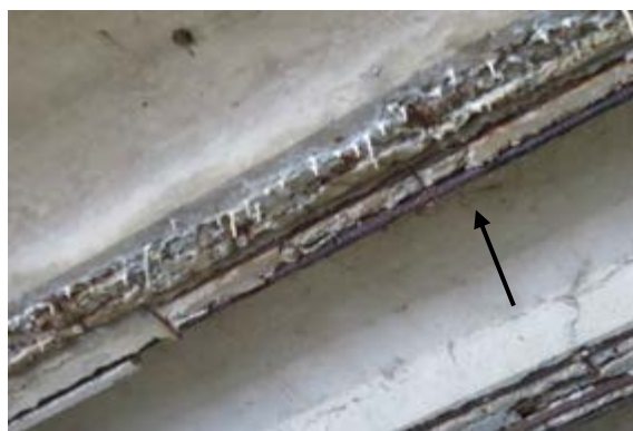
Рис. 3. Хлоридная коррозия железобетонных элементов пролётной части автомобильного моста
