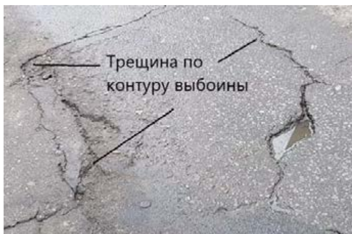
Рис. 3. Фото 1. Трещина по контуру выбоины через 1 год после ямочного ремонта
