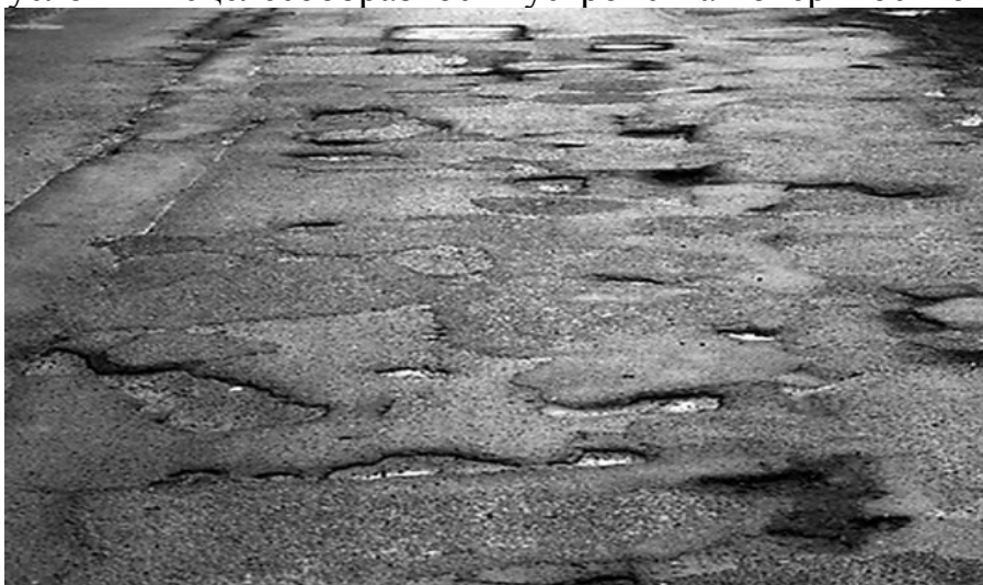
Рис.1. Вид дорожного покрытия в процессе эксплуатации автомобильной дороги
