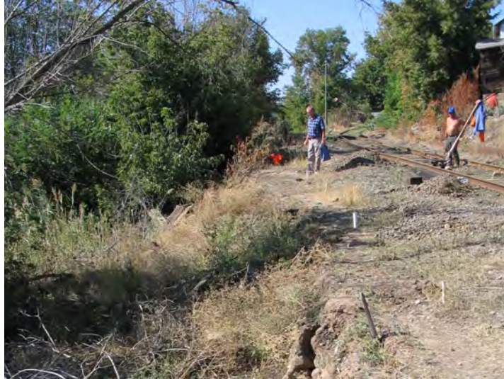
Рис. 1. Оползневые деформации около железной дороги Речного порта
