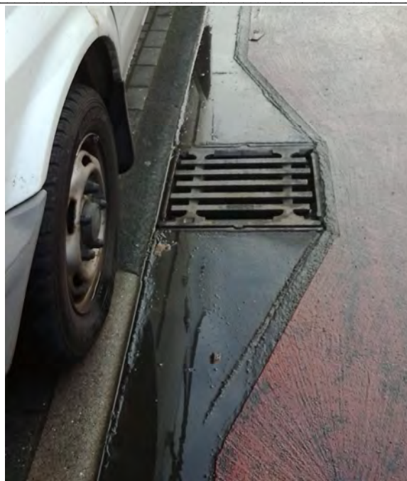
Рис. 9. Дождеприемный колодец в зоне парковки
