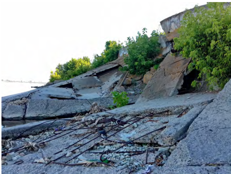
Рис. 1. Разрушенное берегоукрепление у ТОС «Строитель»
