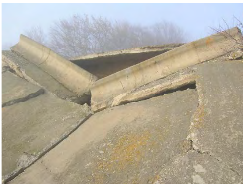
Рис. 6. Разрушенный участок берегоукрепления в Кировском районе
