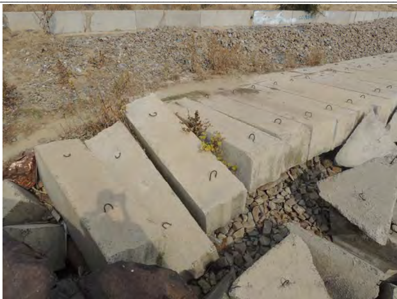
Рис. 4. Деформация укрепительных сооружений в Дубовке
