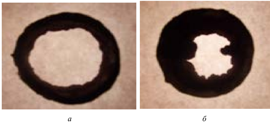
Рис. 1. Коррозия трубопроводов различных лет эксплуатации d = 40 мм: a — 10 лет; б — 21 год
