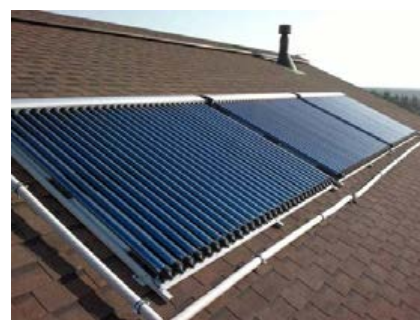
Рис. 7. Современная гелиоустановка на крыше здания (общий вид)
