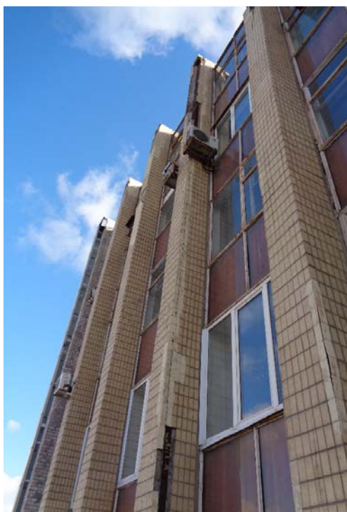
Рис. 3. Техническое состояние пилонов вдоль оси Б в осях 17—15
