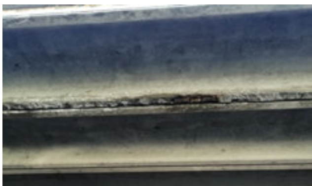
Рис. 7. Коррозия рабочей арматуры ребра балки
