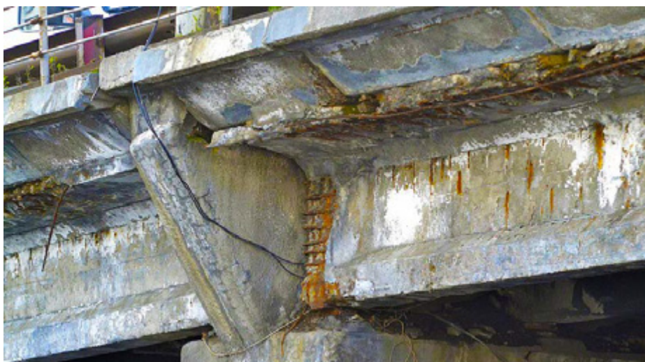
Рис. 1. Коррозия бетона мостовой железобетонной балки
