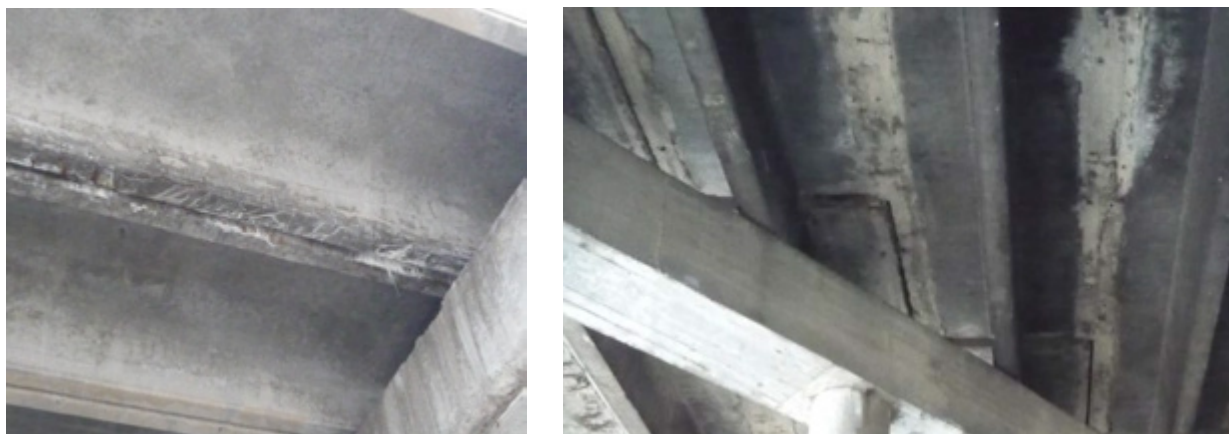
Рис. 1. Углекислотная коррозия бетона балок пролетного строения
