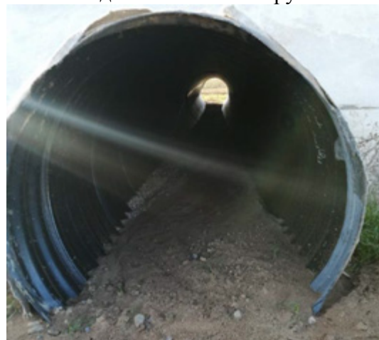
Заиливание отверстия трубы
