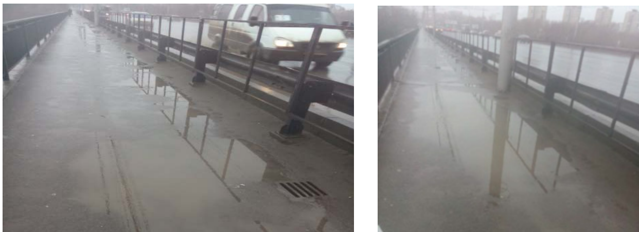
Рис. 2. Застой дождевой воды на пролетном строении
