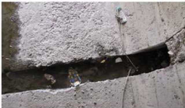
Разрушения стыка между звеньями трубы
