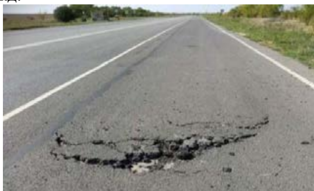
Рис. 1. Разрушения проезжей части дороги Волгоград – Октябрьский – Котельниково
