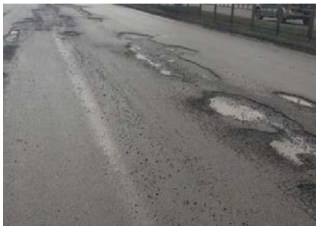
Рис. 1. Покрытие улицы 64 Армии г. Волгограда через 6 месяцев после ремонта (март 2014г.)
