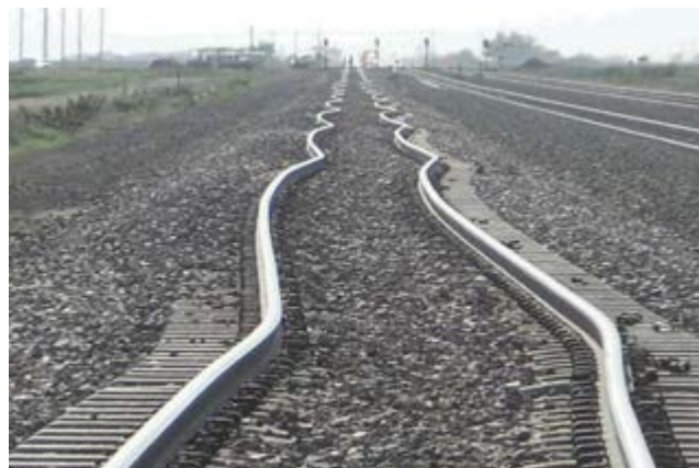
Рис. 2. Деформация рельсового пути при неправильном закреплении плетей
