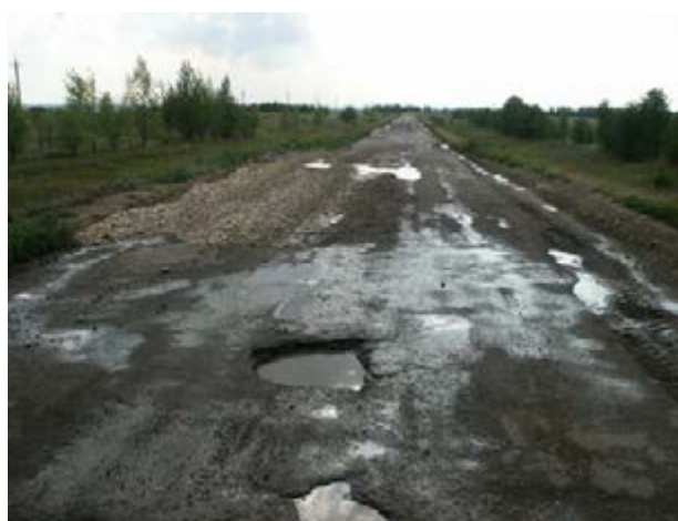
Рис. 2. Состояние существующей дороги
