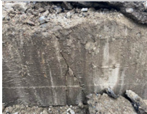
Рис. 4. Поперечная трещина в переходной плите
