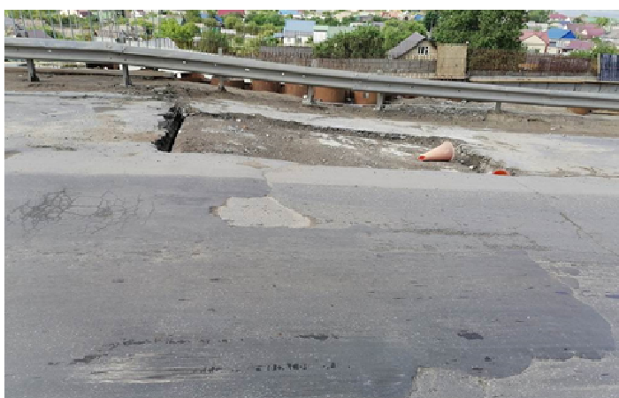
Рис. 3. Просадка переходной плиты
