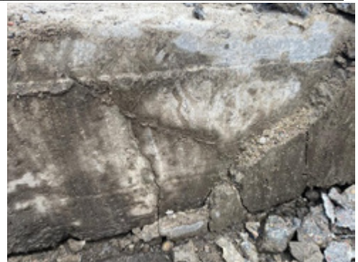
Рис. 5. Сеть трещин с шириной раскрытия до 5 мм
