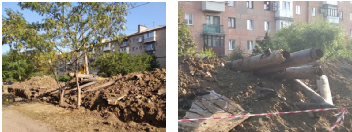
а б Рис. 1. Замена старых труб теплосети (г. Горловка, ул. Рудакова, 2023 г.): а — демонтаж старых труб; б — извлеченные и не пригодные для дальнейшей эксплуатации трубы
