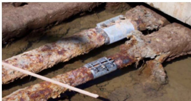
Рис. 1. Коррозионное разрушение трубопроводов
