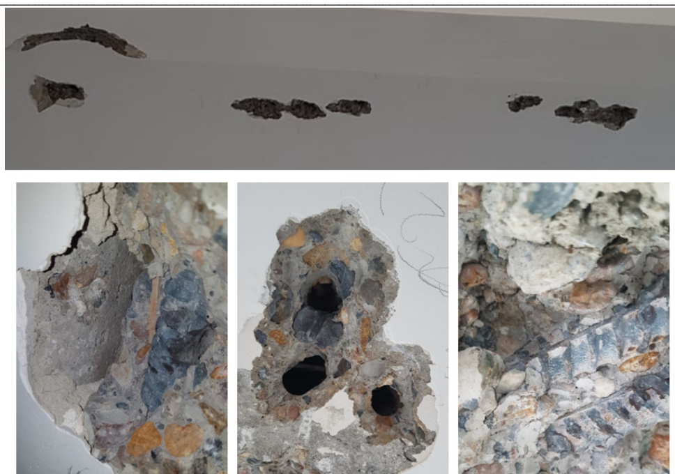
Рис. 5. Механические вскрытия арматуры
