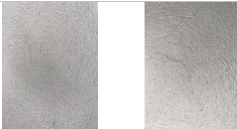
Рис. 7. Повреждения (волосные трещины) на поверхности фрагмента кладки, оштукатуренного снаружи цементной штукатуркой, после заданного цикла климатических воздействий
