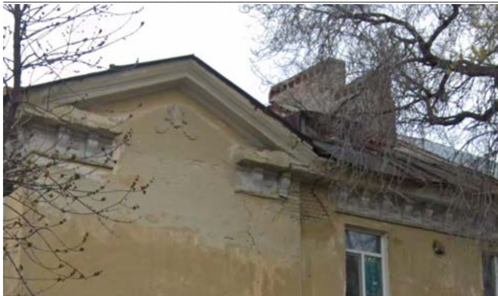
Рис. 4. Трещины на фасаде
