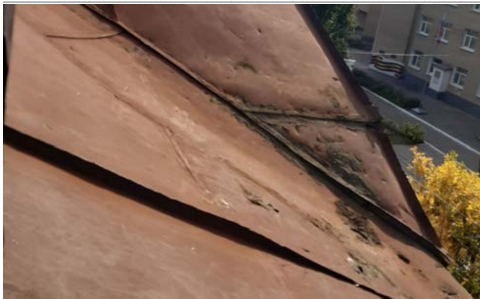
Рис. 7. Коррозия и разрушение фальца
