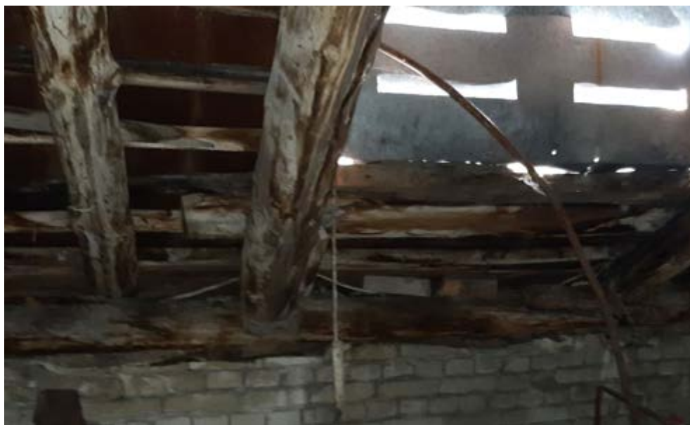
Рис. 8. Следы замачивания конструкций стропил, смятие в опорных участках
