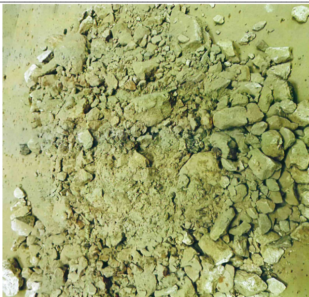
Рис. 10. Состояние щебня в основании дороги Волгоград — Краснослободск — Средняя Ахтуба
