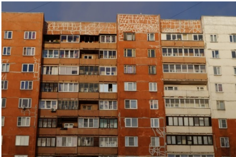
Рис. 3. Повреждение панелей в зданиях первых массовых серий
