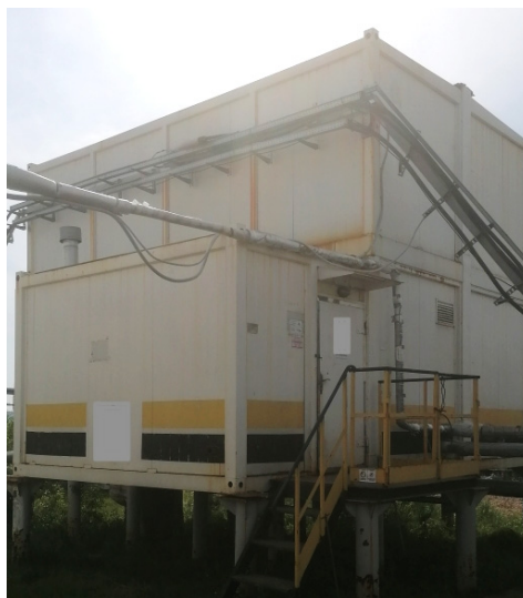
Станция биологической очистки хозяйственно-бытовых сточных вод «КСкомплект-100СК»
