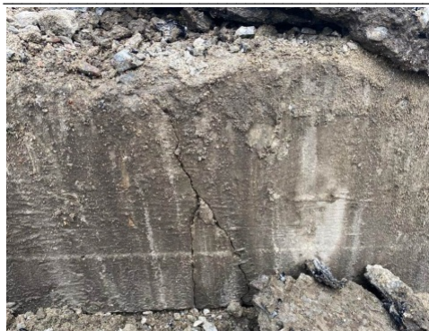
Рис. 4. Поперечная трещина в переходной плите
