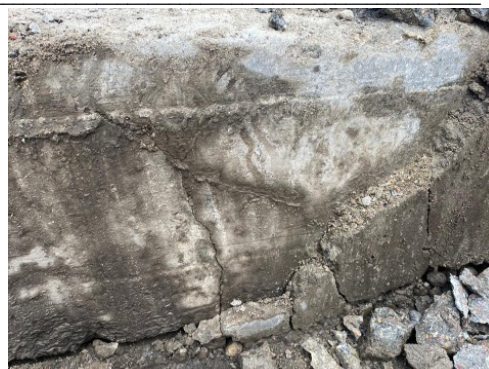
Рис. 5. Сеть трещин с шириной раскрытия до 5 мм
