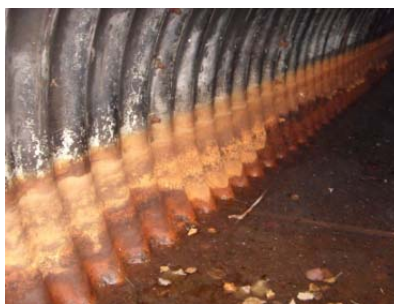
Рис. 1. Коррозия тела трубы на автодороге Р-228 Волгоградской области.
