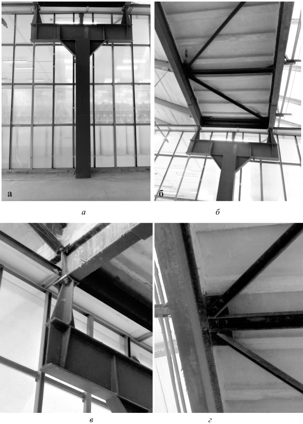
Рис. 4. Колонна и узлы сопряжения колонны с балкой: a — колонна К1; б — участок плоской зоны, крепление колонны к горизонтальной балке 30 а, горизонтальные связи вдоль плоской зоны-лотка; в — узел опирания горизонтальной балки 30а на колонну; г — узел стыковки горизонтальных связей, примыкающих к двутавровой балке 30а и железобетонной ребристой плите с помощью высокопрочных болтов
