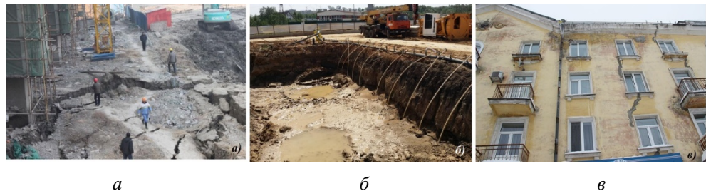
Рис. 1. Последствия принятия неправильных решений: а — последствия фильтрационной консолидации грунта; б — разуплотнение дна котлована в процессе водопонижения иглофильтрами; в — появление трещин в существующей малоэтажной исторической застройке на пр. Энгельса в г. Санкт-Петербурге, попавшей в зону влияния вновь возводимых многоэтажных зданий
