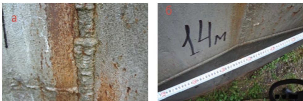
Рис. 4. Дефекты на ПВХ [6]: а — усталостные трещины по зоне сплавления шва; б — угловые деформации в вертикальном стыковом монтажном сварном соединении стенки
