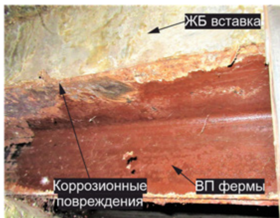
Рис. 5. Коррозионные повреждения поясов в зоне контакта с железобетонными плитами в результате систематического замачивания
