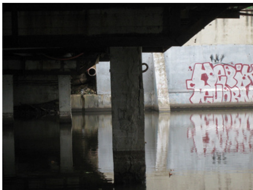
Рис. 6. Опора 2. Верхняя сторона. Свая 3. Вертикальная трещина (мост по ул. Фрунзе в р-не Комсомольского пруда в Липецке)
