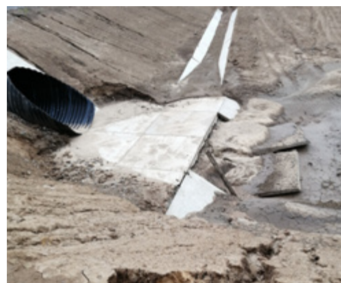
Рис. 6. Размыв укрепления трубы на выходе
