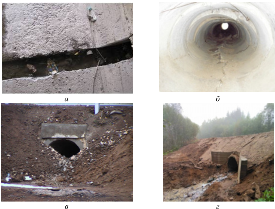
Рис. 1. Дефекты железобетонных водопропускных труб: a — разрушения стыка между звеньями трубы; b — раздавливание тела трубы; v — замылы грунта отверстия трубы; z — размыв русла трубы
