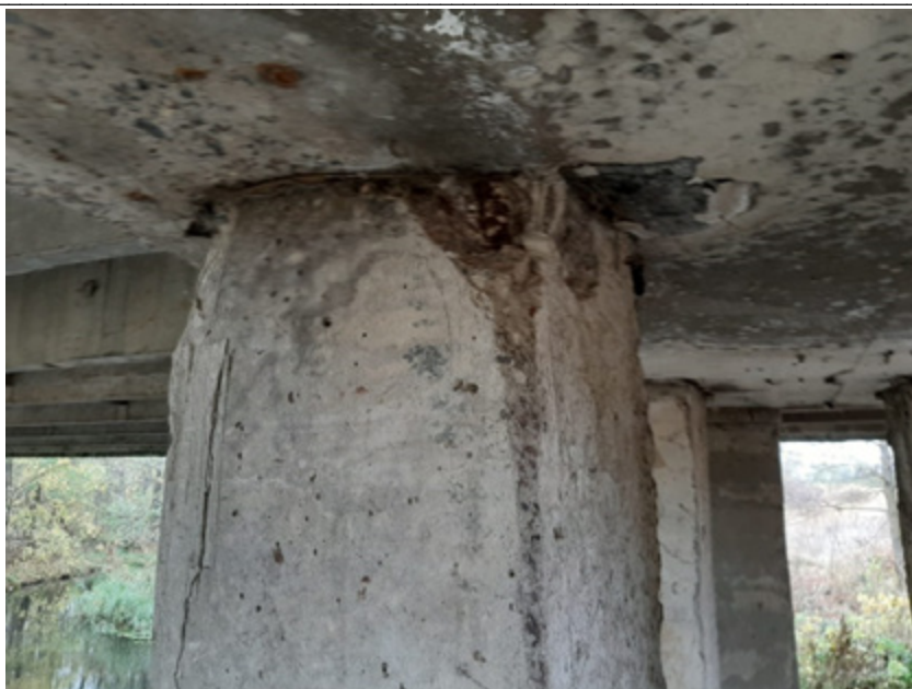
Рис. 3. Опора 3. Свая № 3. Ряд свай № 1. Разрушение бетона в месте сопряжения сваи с насадкой (мост через р. Делеховка на км (21+851) автомобильной дороги Липецк — Доброе — Чаплыгин с подъездом к с. Филатовка в Добровском р-не Липецкой области)
