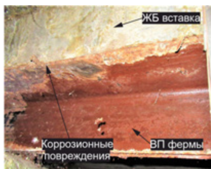
Рис. 5. Коррозионные повреждения поясов в зоне контакта с железобетонными плитами в результате систематического замачивания
