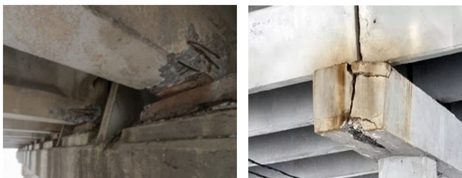
Рис. 1. Износ конструкций: a — разрушение торца балки; b — разрушение ригеля
