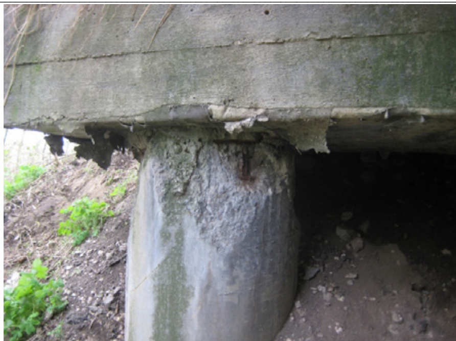
Рис. 5. Опора 1. Столб № 8. Зона сопряжения с ригелем. Скол бетона с обнажением и коррозией арматуры. S = 0,30 \text{ м}^2 (мост через р. Ериловка на км (7 + 015) автомобильной дороги общего пользования регионального значения Вербилково — Грязное — Боринское в Липецком р-не Липецкой области)
