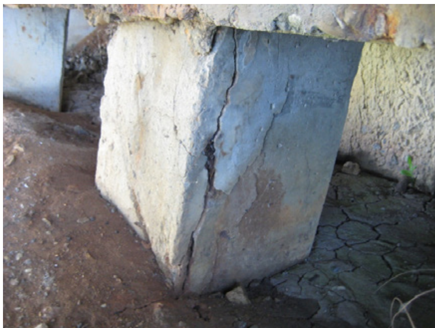
Рис. 4. Опора 1. Ряд свай № 2. Свая 2. Разрушение защитного слоя бетона. Вертикальная трещина с шириной раскрытия до 6 мм (мост через р. Пальна на км (15 + 110) автомобильной дороги общего пользования регионального значения Становое — Троскурово — Лебедин в Становлянском р-не Липецкой области)
