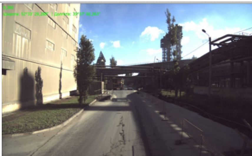
Рис. 3. Повреждения на поверхности асфальтобетонного покрытия
