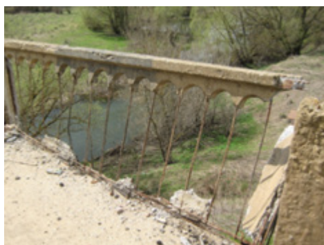
Рис. 1. Пролет 1. Верховая сторона. Блок 1. Перильное ограждение. Потеря устойчивости ограждения. Опасность обрушения
