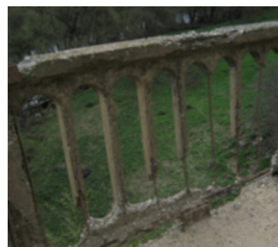
Рис. 2. Пролет 2. Низовая сторона. Перильное ограждение. Блок 14. Интенсивное разрушение бетона с обнажением арматуры
