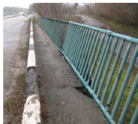
Рис. 4. Крен конструкции перильного ограждения. Разрушение крепления элементов к мостовому сооружению
