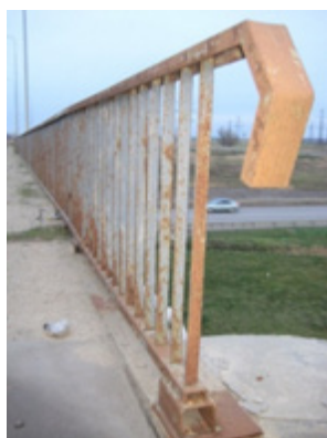
Рис. 3. Перильное ограждение. Сплошная коррозия металлической поверхности элементов конструкции
