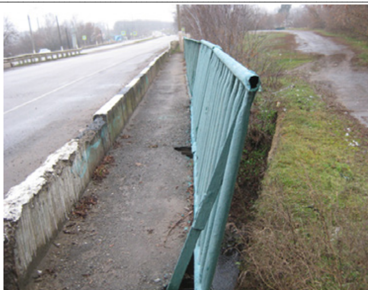
Рис. 5. Крен конструкции перильного ограждения. Потеря вертикальности и устойчивости
